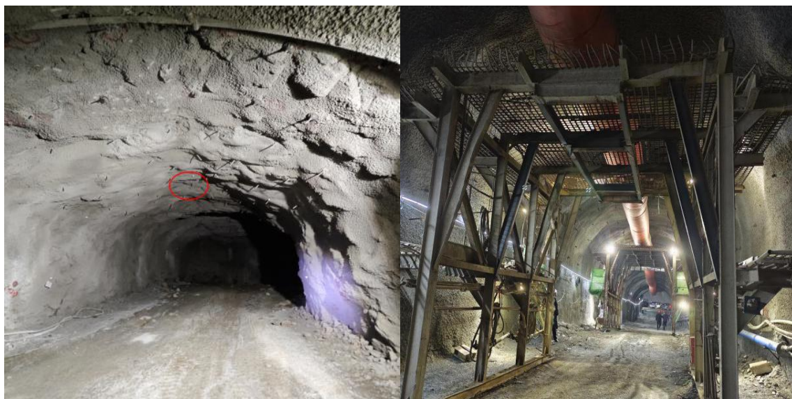
（调压井作业面及落石区域）
